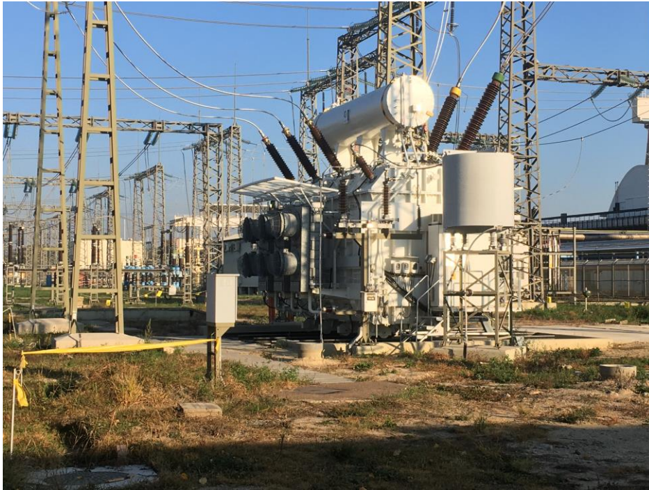
2. kép 220/120 kV transzformátor
