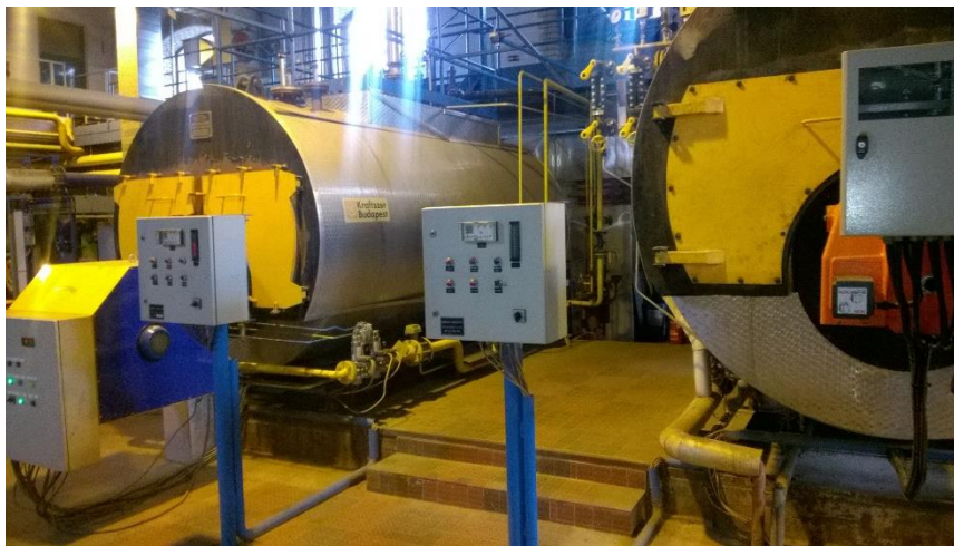
3. ábra: Hő épületben lévő kazánok
