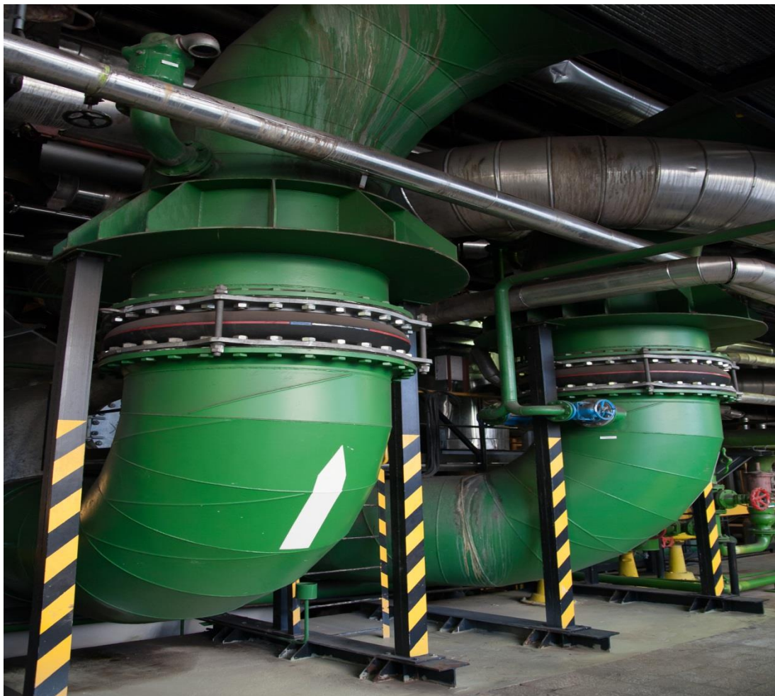
2. Kép A kondenzátor, és az abba be- és kilépő vezetékek
