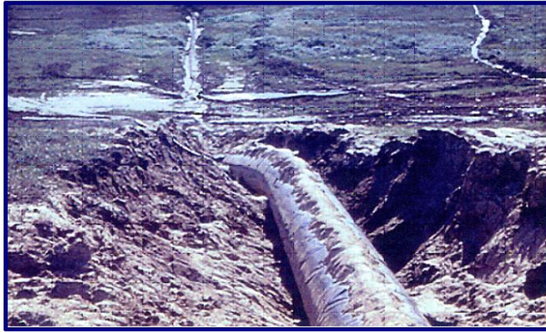
1. ábra: Megsüllyedt vezeték a permafroszton
